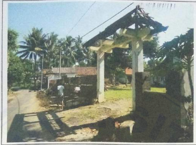
FOTO PAS. PLESTERAN & BESI REHAB PAGAR & GAPURA KANTOR DESA DUSUN DUK LENGKONG DESA SUMBER WRINGIN
