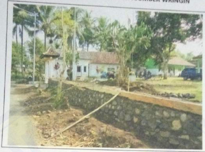
FOTO PAS. SLOOF & KOLOM REHAB PAGAR & GAPURA KANTOR DESA DUSUN DUK LENGKONG DESA SUMBER WRINGIN
