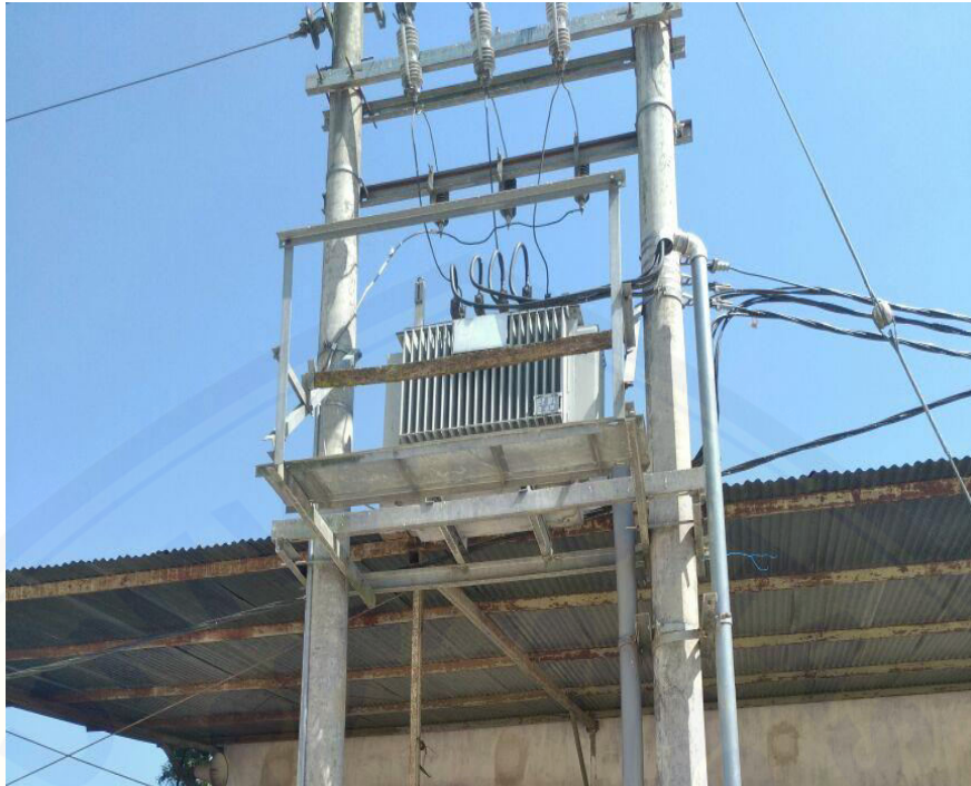
GAMBAR 3. TRANSFORMATOR PABRIK BERAS PT. DUA ANAK KALISAT
