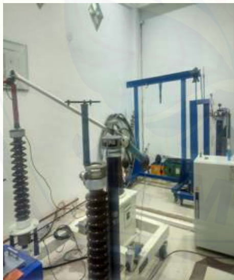
Peralatan Pembangkit Tegangan Tinggi
