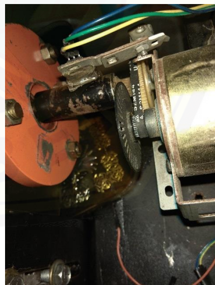
Couple Turbin (Air Motor) dengan Generator
