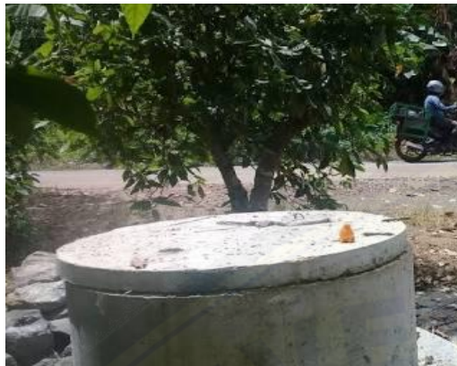
Gambar 17. Tutup Sumur yang Memenuhi Peryaratan
