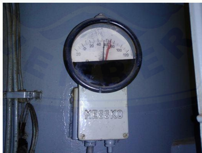
Gambar 4.17 Suhu transformator 3 saat pengujian
