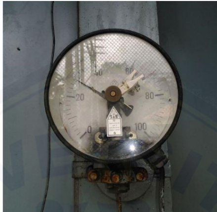
Gambar 4.14 Suhu transformator 1 saat pengujian
