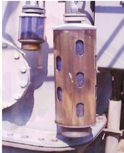
Gambar 2.7 Tempat Minyak Isolasi Pada Trafo ( Sumber : Buku Pedoman Trafo Tenaga, 2014 )
