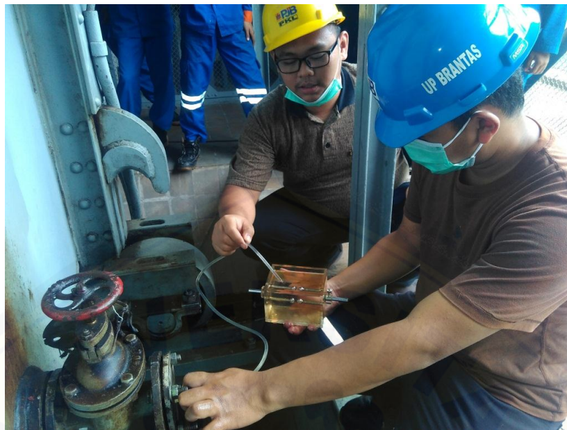
Gambar Proses Pengambilan Minyak Pada Transformator Untuk Uji Tegangan Tembus
