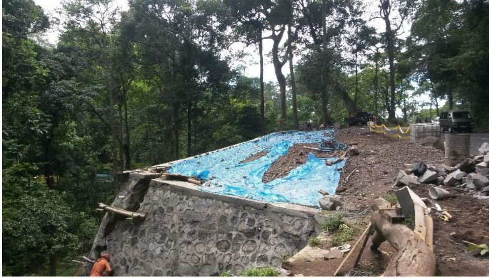
Gambar 2.2 Kerusakan struktur sayap DPT Jalan Raya Jember-Banyuwangi
