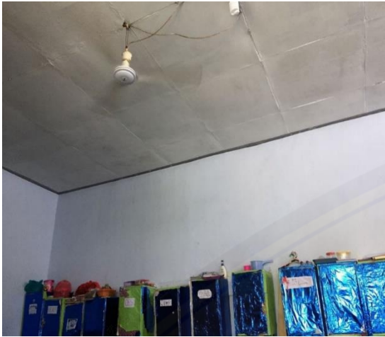
Gambar 13. Atap kamar tidur narapidana perempuan
