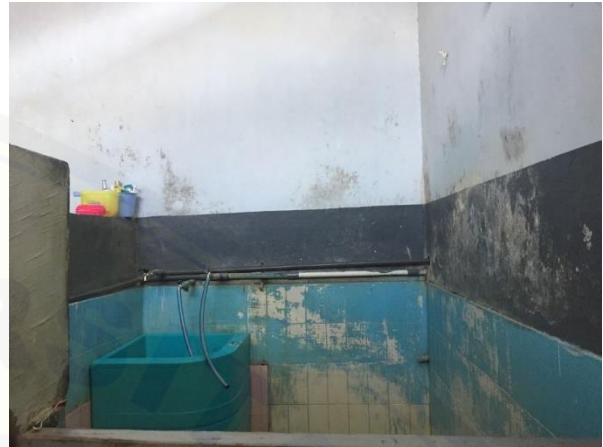
Gambar 10. Kamar mandi narapidana perempuan tanpa atap
