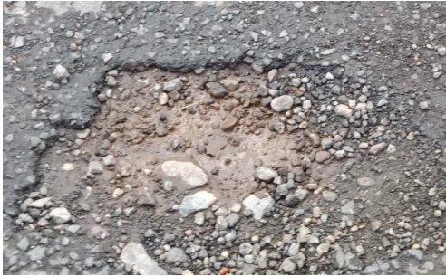
f. Kerusakan Lubang
