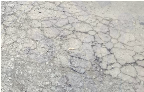
d. Kerusakan Retak
