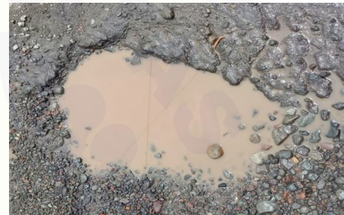
c. Kerusakan Lubang
