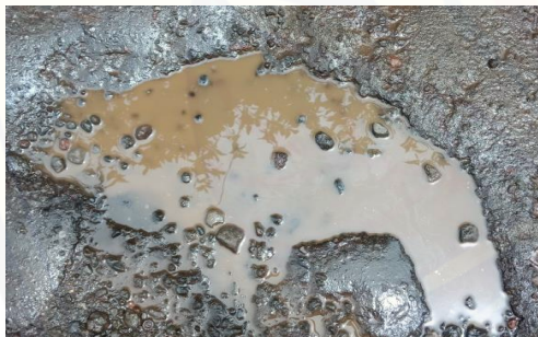
b. Kerusakan Lubang
