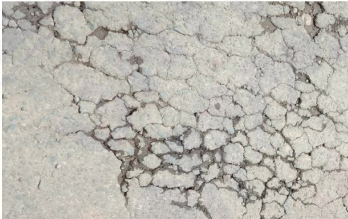
d. Kerusakan Retak
