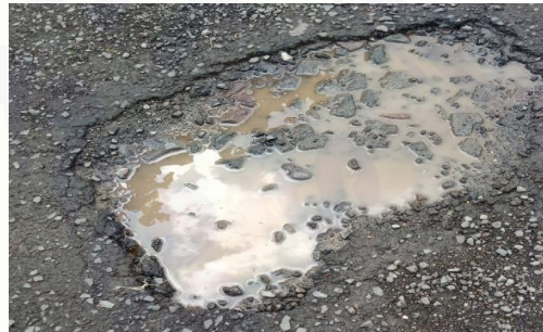
c. Kerusakan Lubang
