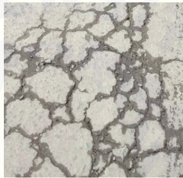
Gambar 2.9 Retak susut (Sumber: Dokumentasi Pribadi)
