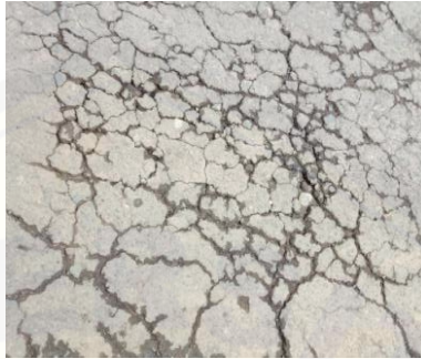
Gambar 2.3 Retak kulit buaya. (Sumber: Dokumentasi Pribadi).
