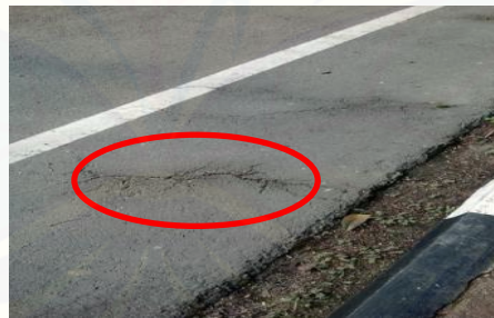
Gambar 2.6 Retak sambungan jalan (Sumber: https://1.bp.blogspot.com/-i1MsL98g- )
