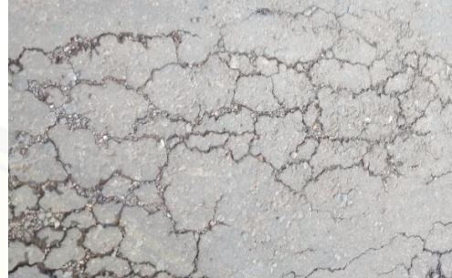
e. Kerusakan Retak
