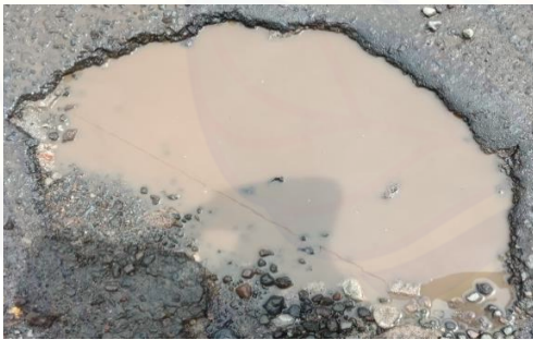
b. Kerusakan Lubang
