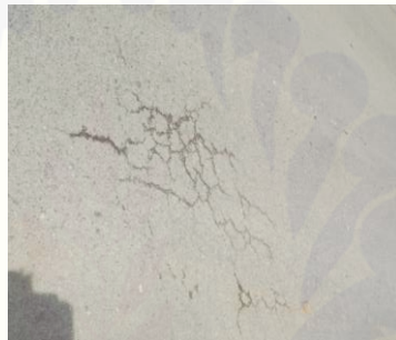
Gambar 2.2 Retak Halus. (Sumber: Dokumentasi Pribadi).
