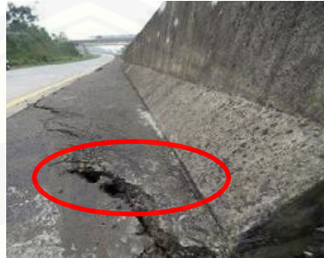
Gambar 2.7 Retak sambungan jalan (Sumber: https://kerusakanjalann.blogspot.com )
