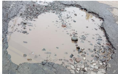
e. Kerusakan Lubang
