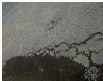
Gambar 2.4 Retak Pinggir. (Sumber: Dokumentasi Pribadi).
