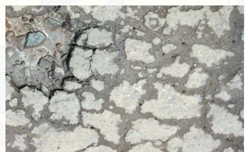
a. Kerusakan Retak
