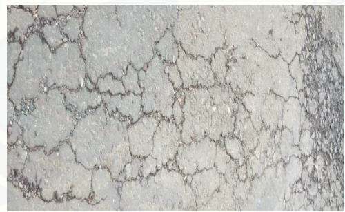
a. Kerusakan Retak
