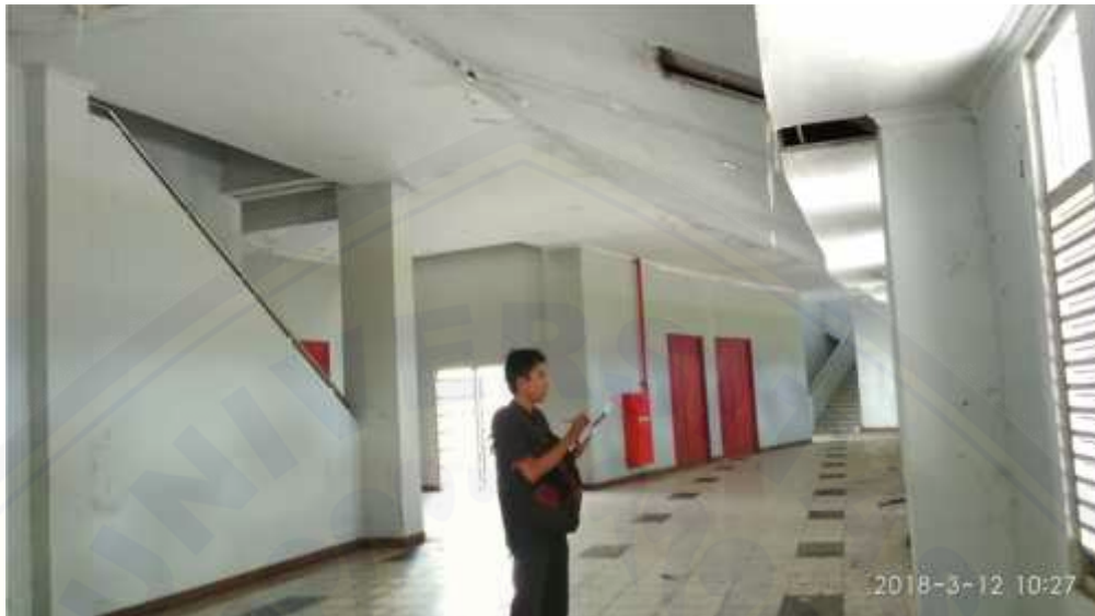
Lampiran 1. Survey Kerusakan Bangunan
