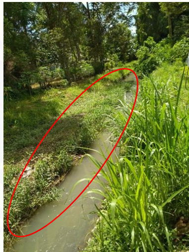
Gambar 2.5 Tumbuhan rumput pada dinding saluran irigasi
