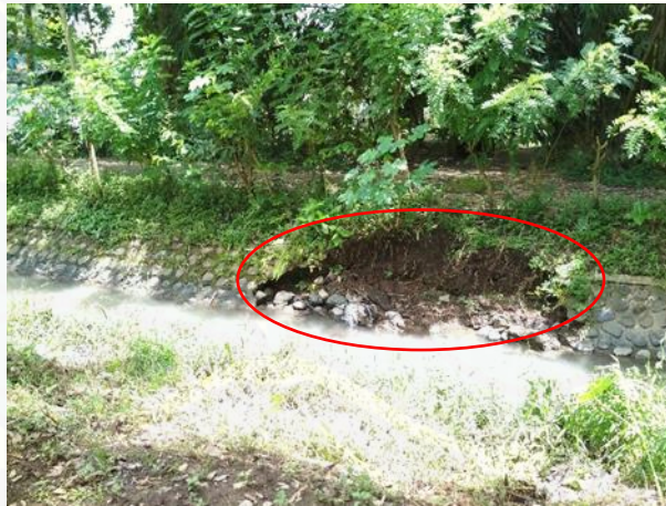
Gambar 2.4 Kerusakan plengsengan pada saluran irigasi
