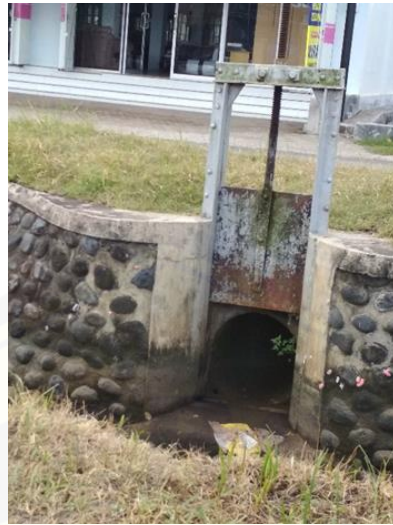
Gambar 2.3 Kondisi pintu air
