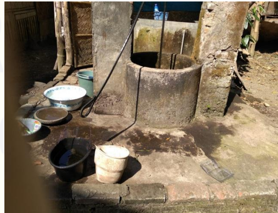
Kondisi Parapet/bibir sumur
