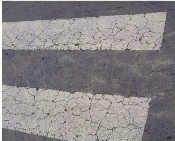
Gambar 2.2. Retak Rambut ( Data Pribadi, 2018 )
