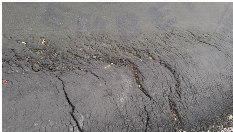
Gambar 2.3. Retak Rambut ( Data Pribadi, 2018 )
