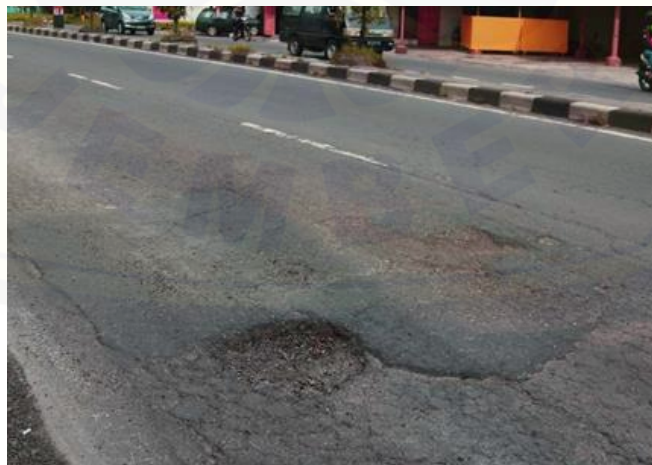
Gambar 2.9 Lubang (Sumber: Google Image, 2018)
