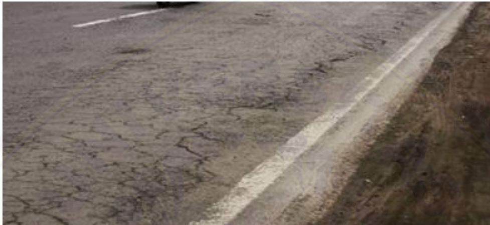
Gambar 2.7 Retak Memanjang ( Sumber: Google Images, 2018 )
