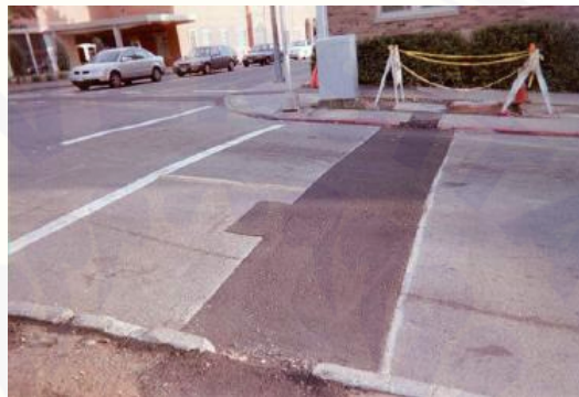
Gambar 2.23 Penurunan pada Bekas Penanaman Utilitas ( utility cut depression ) (Sumber: Google Images)
