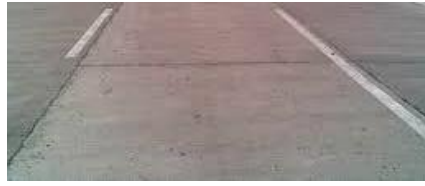
Gambar 2.9 Retak Sambungan Pelebaran Jalan ( widening cracks ) (Sumber: Google Images)
