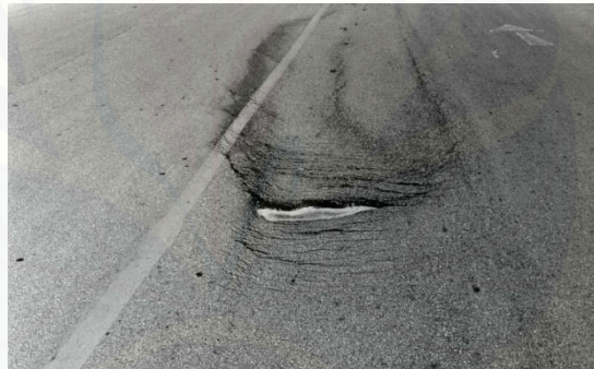
Gambar 2.12 Retak selip ( slippage cracks ) (Sumber: Google Images)
