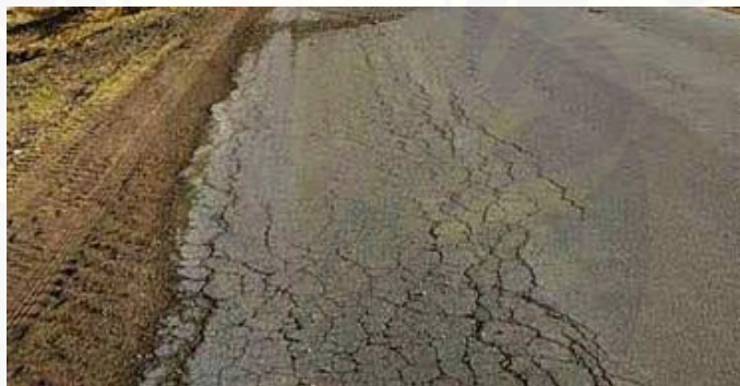
Gambar 2.6 Retak Kulit Buaya ( edge cracking ) (Sumber: Google Images)
