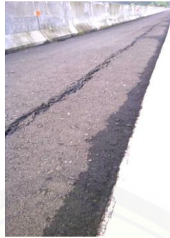
Gambar 2.7 Retak Sambungan Bahu perkerasan ( edge joint crack ) (Sumber: Google Images)
