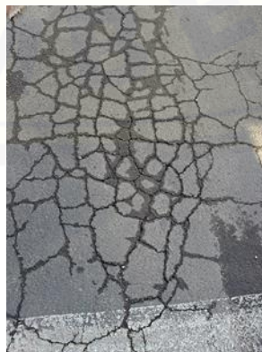
Gambar 2.5 Retak Kulit Buaya ( alligator cracking ) (Sumber: Google Images)
