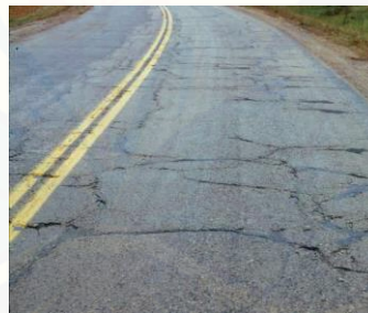
Gambar 2.10 Retak Refleksi ( reflection cracks ) (Sumber: Google Images)
