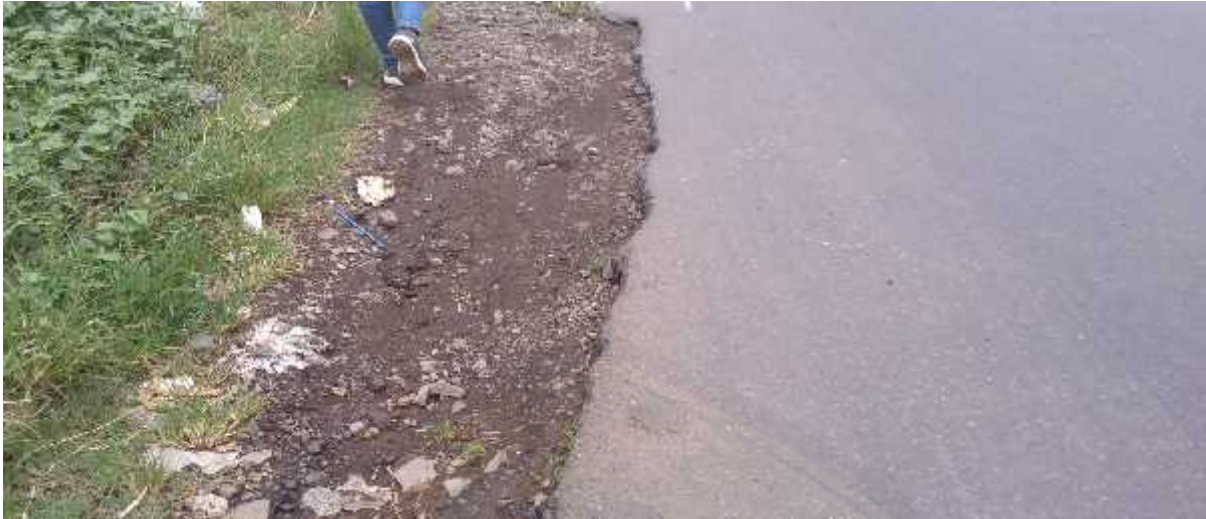
Jenis Kerusakan Rusak Tepi
