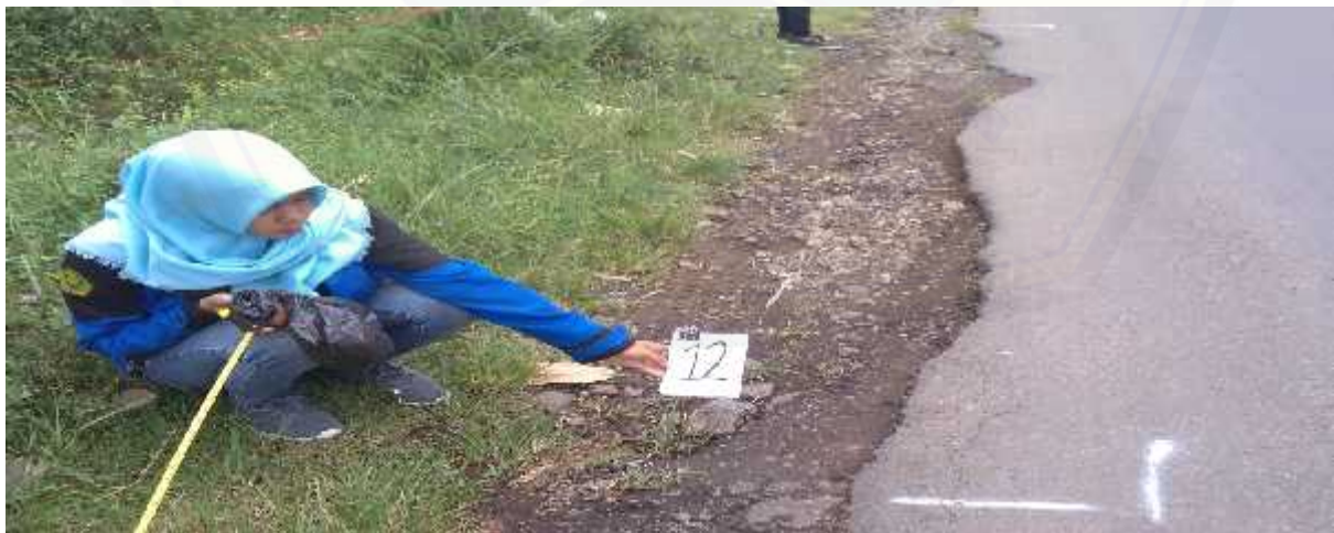
Survei pengukuran jenis kerusakan jalan
