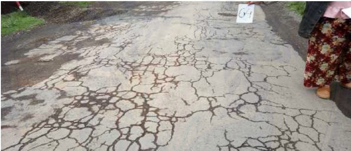
Jenis Kerusakan Retak Kulit Buaya
