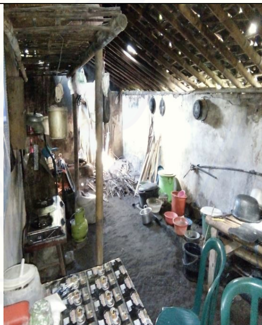
Kondisi Atap, Langit-Langit Dan Dinding Tempat Pengolahan Kue Cenil
