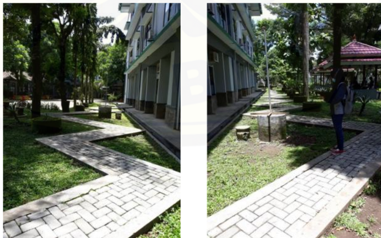
Keterangan: Gedung FEB belum memiliki ground reservoir
