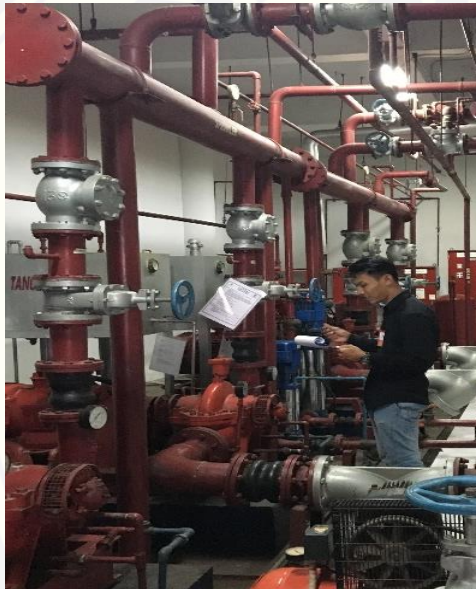
Observasi Sistem Pemipaan dan Tekanan Sprinkler di gedung PT. Telkom Jember
