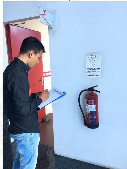
Observasi APAR di gedung PT. Telkom Jember
