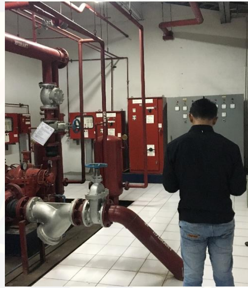
Observasi Sistem Pemipaan dan Tekanan Hidran di gedung PT. Telkom Jember
