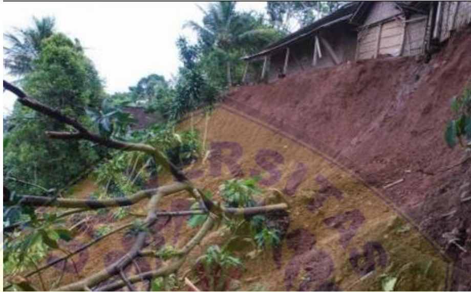
Gambar 2. Kondisi Tanah Longsor di Lokasi Mitra
