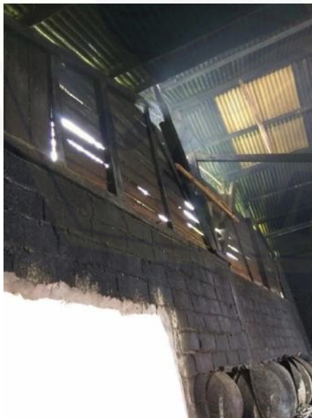
Gambar 3. Kondisi dinding dan atap
