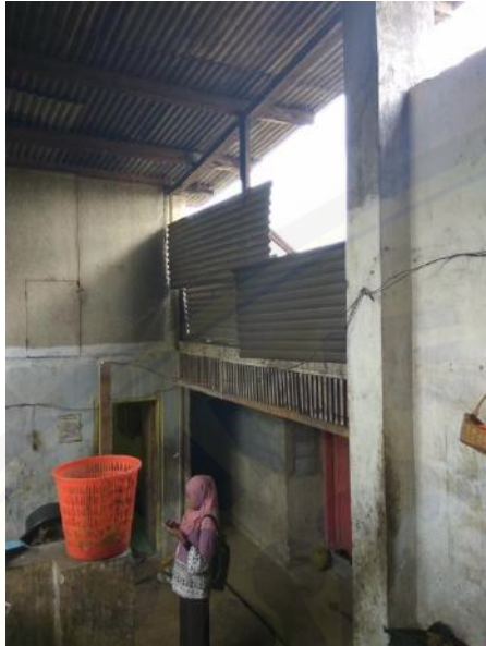
Gambar 1. Kondisi dinding dan atap
