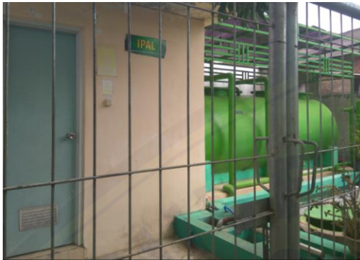
Instalasi Pembuangan Air Limbah (IPAL) di Puskesmas Maesan
