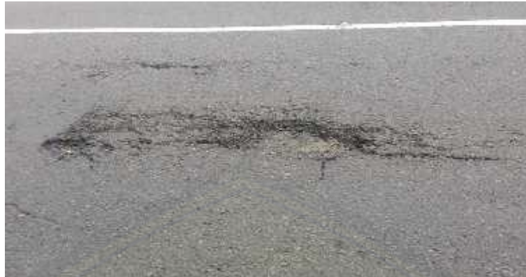
4.16 Gambar Kerusakan Lubang pada Perkerasan
