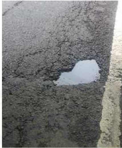
4.22 Gambar Kerusakan Lubang pada Perkerasan
