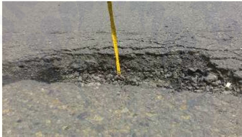
4.20 Gambar Kerusakan Lubang pada Perkerasan
