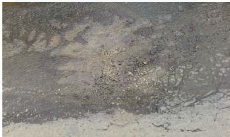
4.18 Gambar Kerusakan Lubang pada Perkerasan
