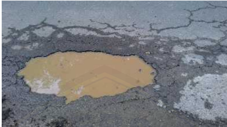
4.19 Gambar Kerusakan Lubang pada Perkerasan
