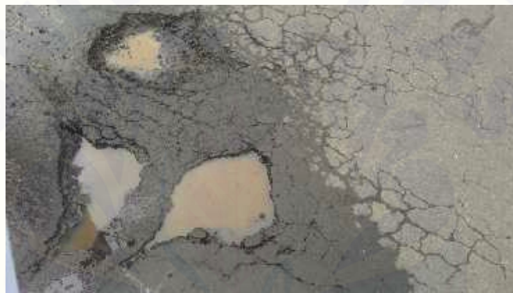
4.17 Gambar Kerusakan Lubang pada Perkerasan
