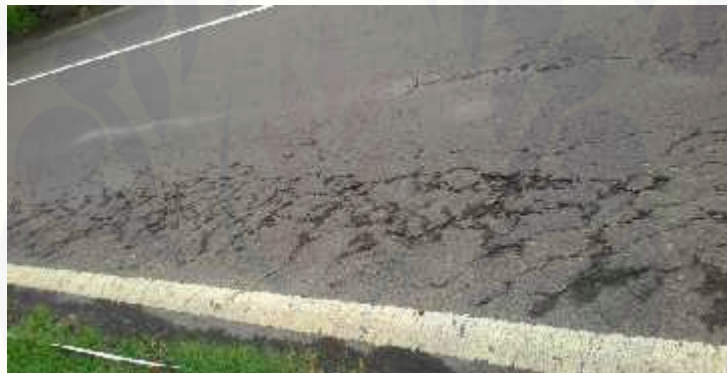
4.23 Gambar Kerusakan Retak pada Perkerasan
