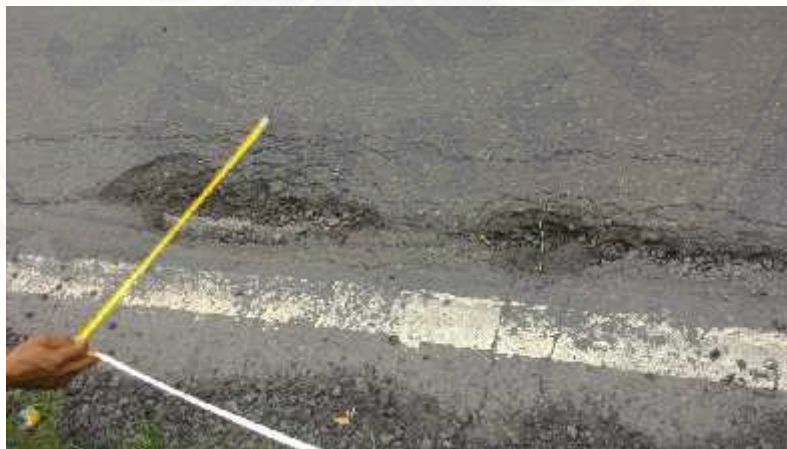
4.21 Gambar Kerusakan Lubang pada Perkerasan
