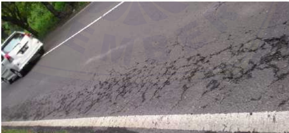
4.24 Gambar Kerusakan Retak pada Perkerasan
