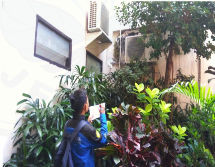
Lampiran 2. Survey Kerusakan Bangunan
