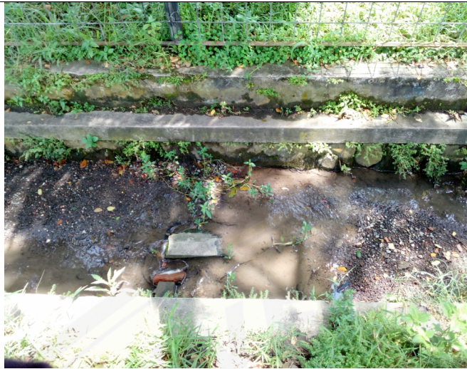
Sedimentasi di salah satu saluran drainase Jalan Mohammad Yamin.
