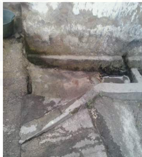
Gambar 12. Kondisi SPAL sumur gali
