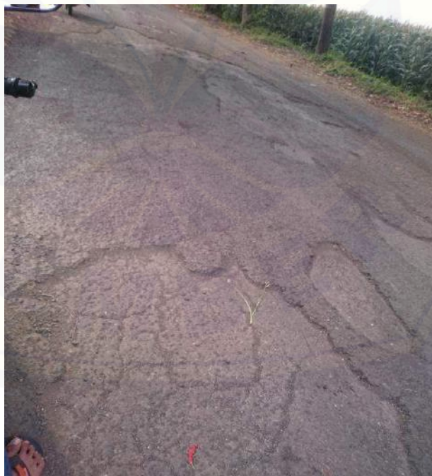
Kerusakan Keriting Kondisi Medium
