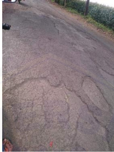
Gambar 2.2 Kerusakan Keriting (Sumber : Dokumentasi, 2016)
