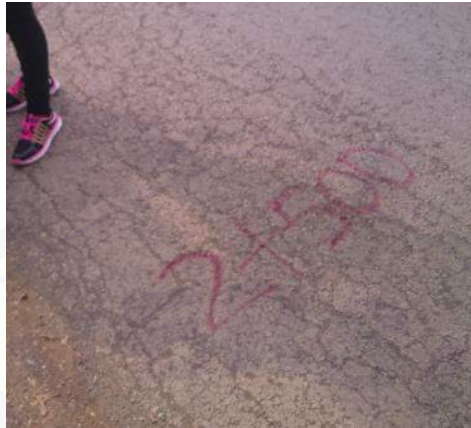
Gambar 2.1 Kerusakan Retak Kulit Buaya (Sumber : Dokumentasi, 2016)
