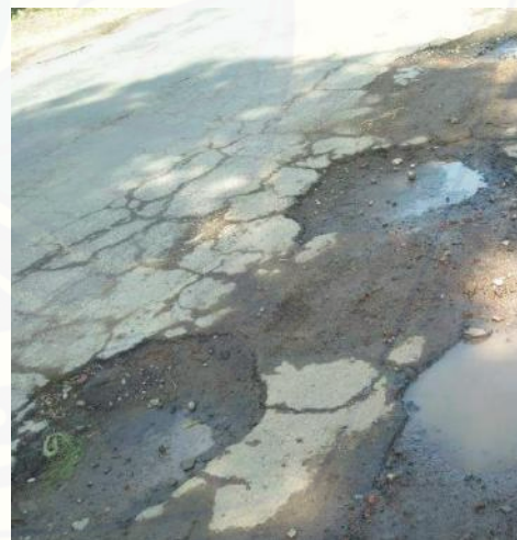
Kerusakan Lubang Kondisi Medium
