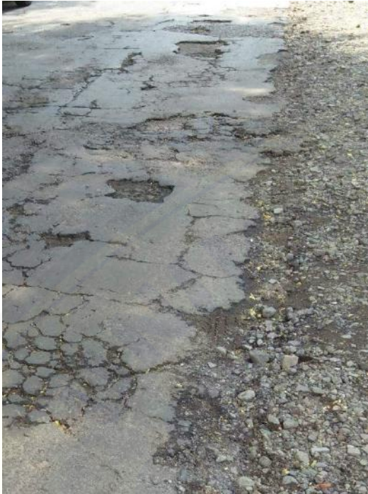
Kerusakan Retak Pinggir Kondisi Low
