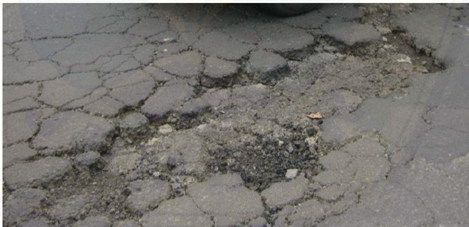
Jenis Kerusakan Retak Buaya Kondisi High
