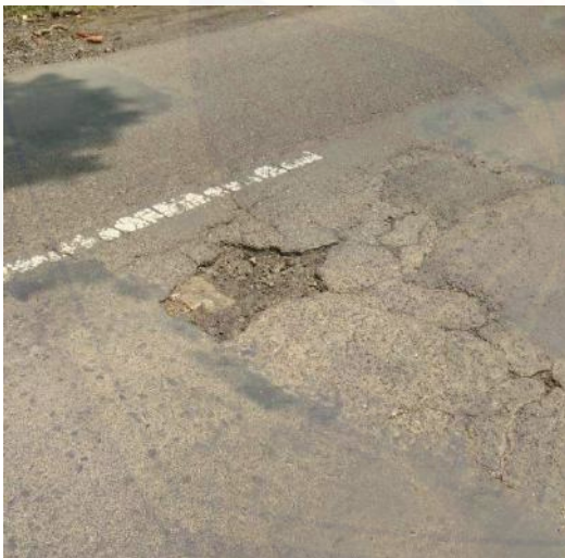
Kerusakan Lubang Kondisi Low
