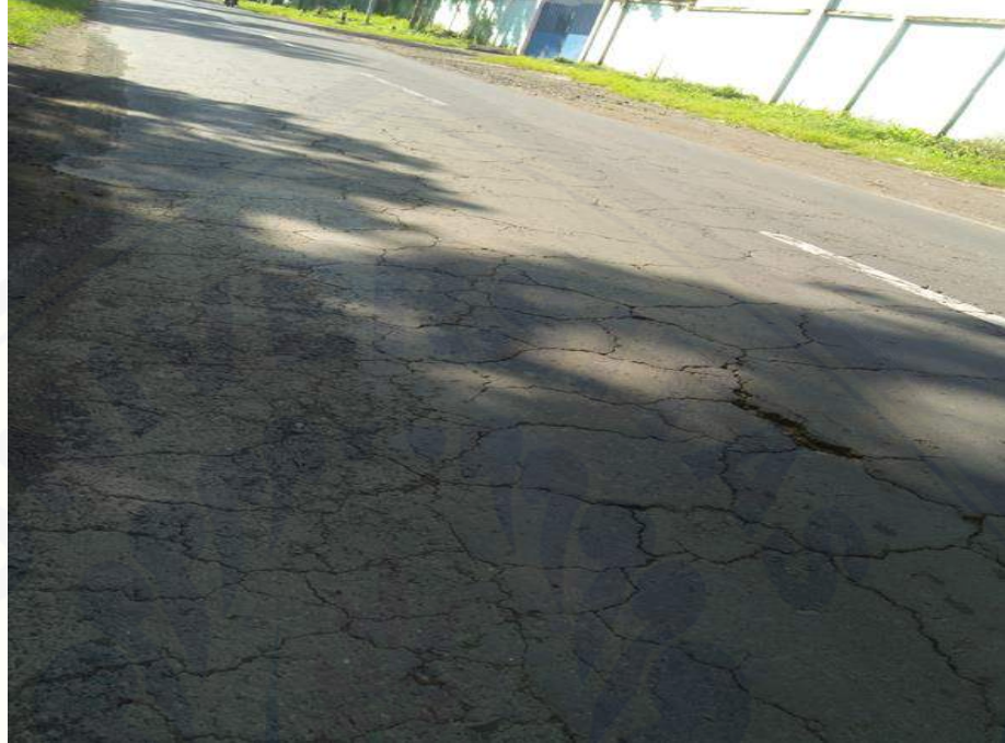
Jenis Kerusakan Retak Buaya Kondisi Low
