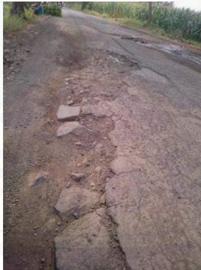
Gambar 2.3 Kerusakan Retak Pinggir (Sumber : Dokumentasi, 2016)
