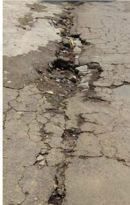
Kerusakan Retak Pinggir Kondisi High
