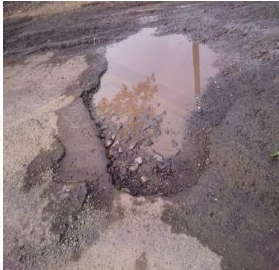
Kerusakan Lubang Kondisi Low
