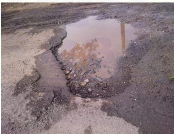
Gambar 2.4 Kerusakan Lubang (Sumber : Dokumentasi, 2016)
