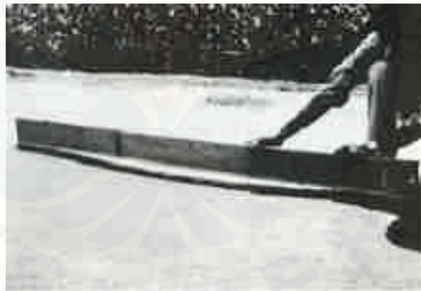
Gambar 2.5 Kerusakan Amblas (Sumber : Google Images, 2016)
