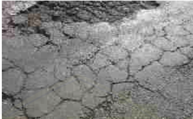
Gambar 2.2 Kerusakan Retak Kulit Buaya (Sumber : Dokumentasi, 2016)
