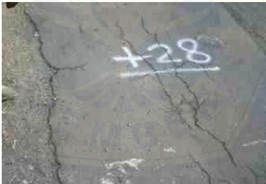
Lampiran D.8 Jenis kerusakan retak memanjang
