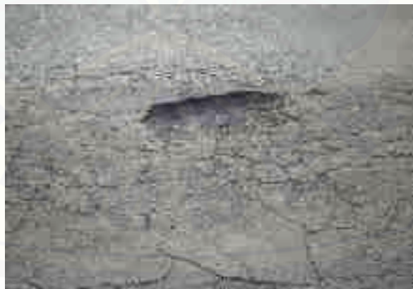
Gambar 2.9 Kerusakan Lubang (Sumber : Dokumentasi, 2016)
