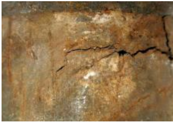
Gambar 2.7 Korosi Tegangan (Sumber: Utomo, 2009)
