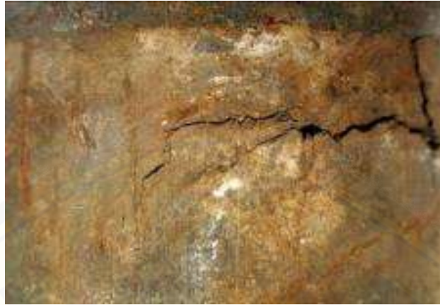
Gambar 2.4 Korosi Tegangan (Sumber: Utomo, 2009)
