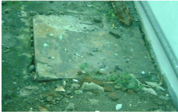
Gambar 4.6 Saluran pembuangan air limbah dalam kondisi tertutup
