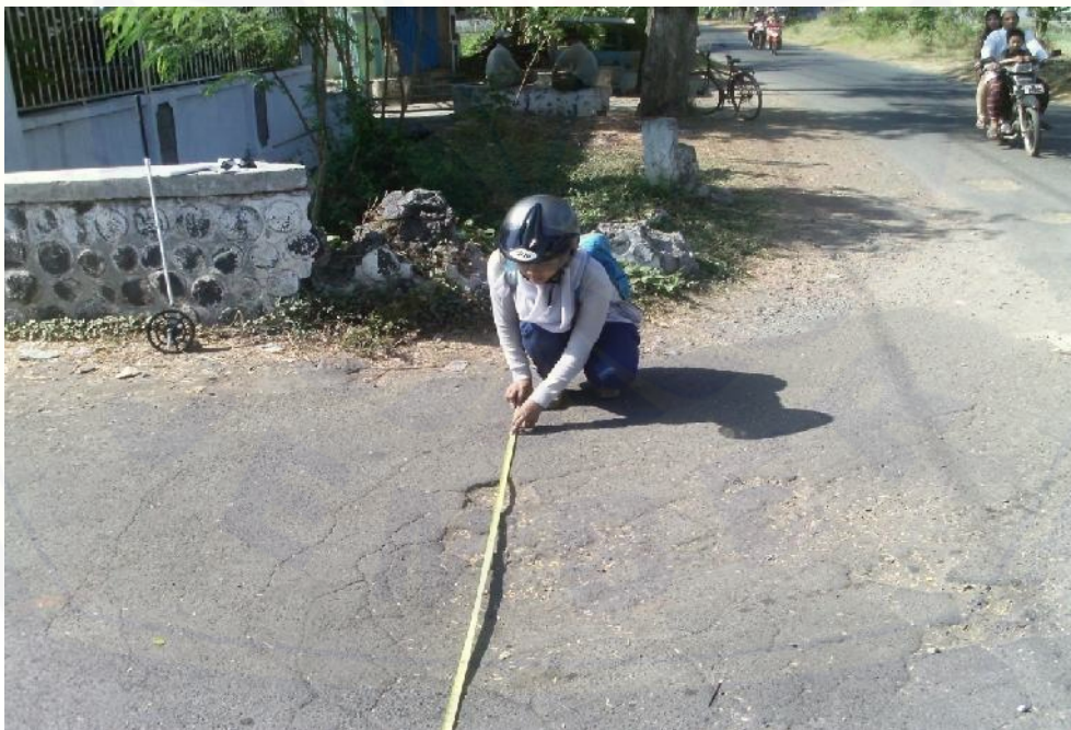
Kondisi Jalan Ngepoh-Sumberkerang
