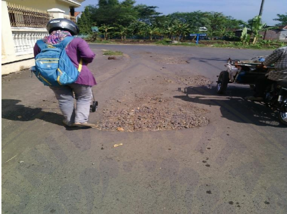
Kerusakan Jalan Jenis Lubang di Jalan Jorong-an-Kerpangan (terlihat becak motor sampai mengambil jalur kanan jalan untuk menghindari kerusakan)
