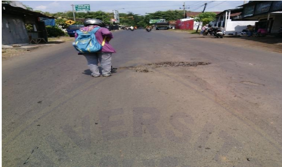
Kerusakan Jalan Jenis Lubang di Jalan Klenang Lor-Klenang Kidul
