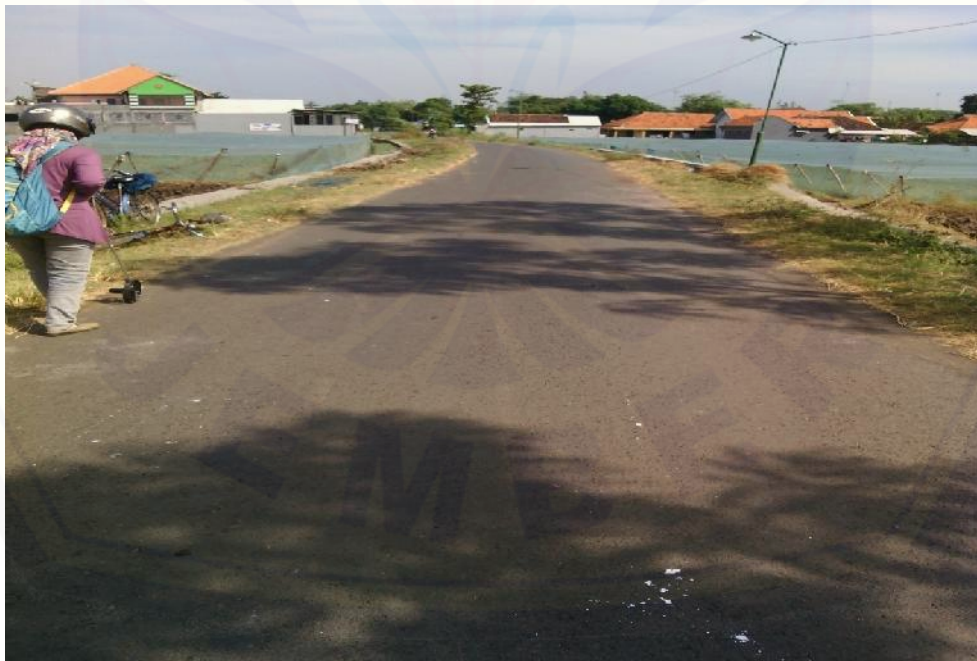
Kondisi Jalan Kerpangan-Pasar Leces
