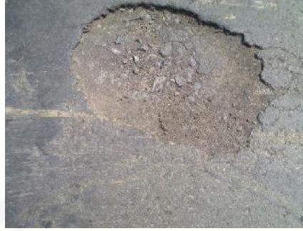
Gambar 2.3 Lubang ( potholes ) (Sumber: Dokumentasi, 2014)
