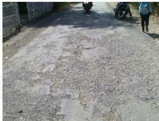
Gambar 2.6 Pelepasan Butiran ( Weathering/Raveling ) (Sumber: Dokumentasi, 2014)
