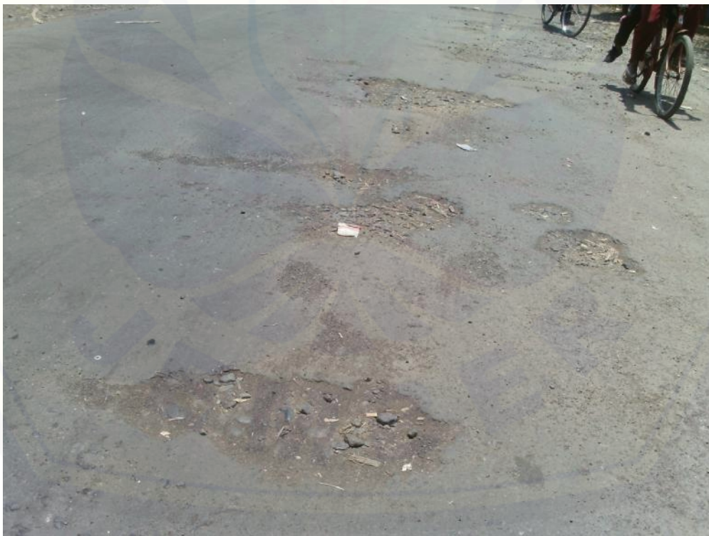
Kerusakan Jenis Lubang Di Jalan Sebaung-Klenang Lor
