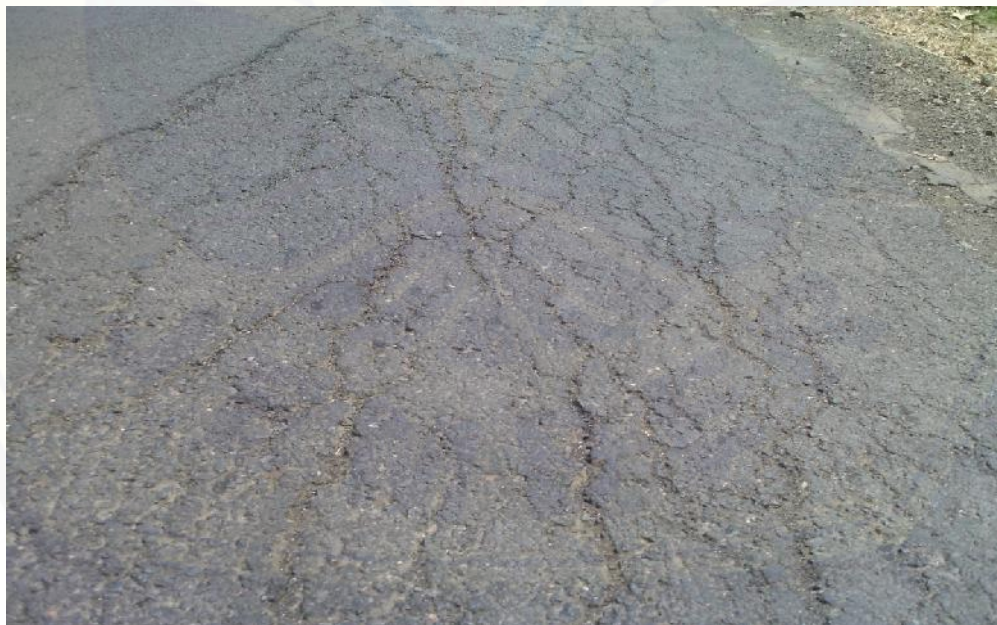
Kerusakan Jalan Retak Memanjang di Jalan Klenang-Pesawahan
