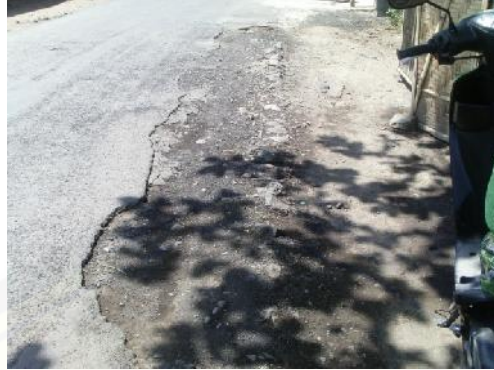
Gambar 2.4 Retak Tepi ( Edge Cracking ) (Sumber: Dokumentasi, 2014)
