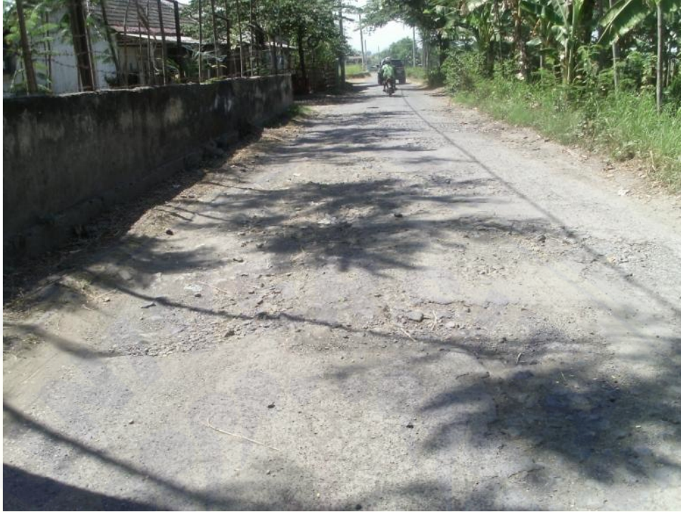
Kerusakan Pelepasan Butiran Di Jalan Pajurangan-Banyuanyar
