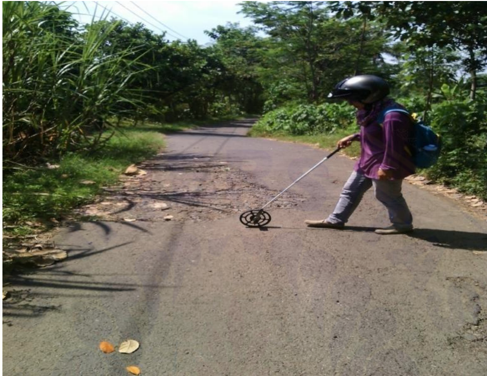
Kerusakan Jalan Pelepasan Butiran di Jalan Malasan Wetan-Gunung Bekel
