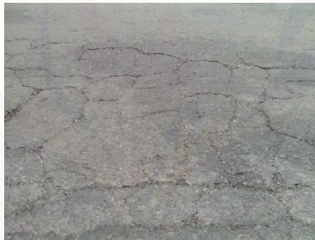
Gambar 2.1 Retak buaya (Sumber: Dokumentasi 2014)
