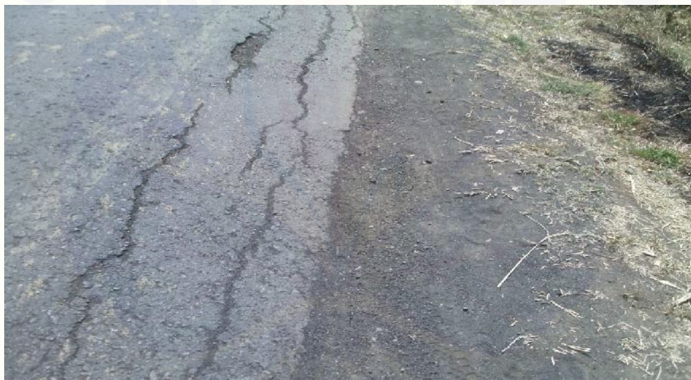
Kerusakan Retak Pinggir Di Jalan Klenang Kidul-Pekalen
