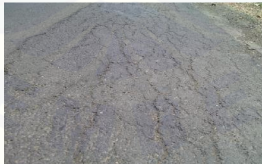
Gambar 2.5 Retak Memanjang dan Retak Melintang ( Longitudinal and Transfersal Cracks ) (Sumber: Dokumentasi, 2014)
