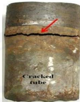
Gambar 2.9 Korosi Retak Pada Pipa (Sumber: Efektifitas Penggunaan Literatur Universitas Indonesia (Online)).
