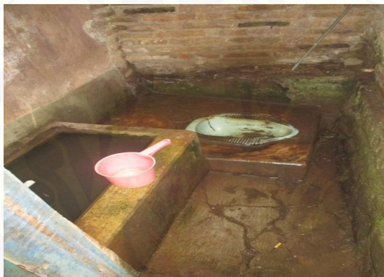
Gambar 4.25 Kondisi Toilet yang Kotor
