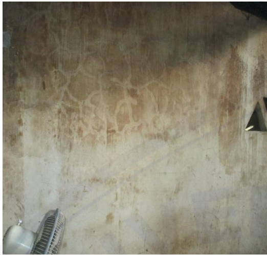
Konstruksi Dinding dan Kondisi Kotor
