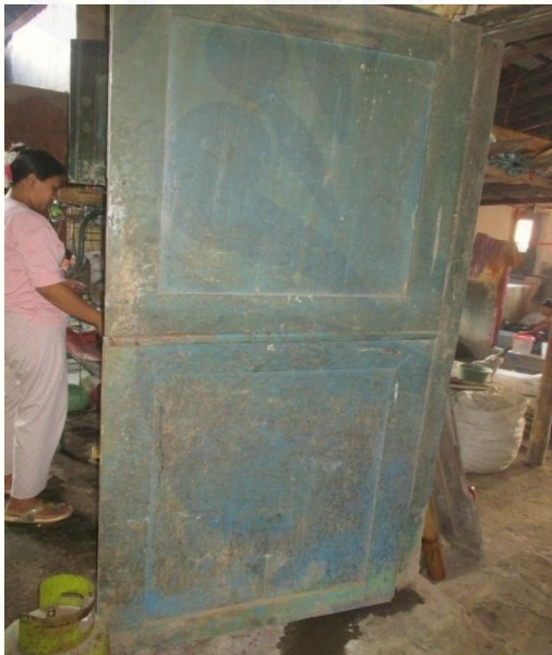
Konstruksi Pintu Kurang Memenuhi Persyaratan
