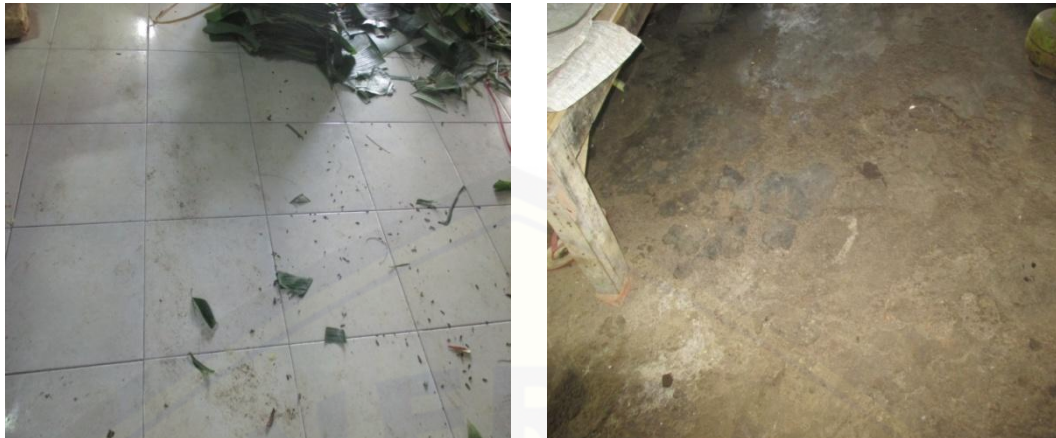
Gambar 4.8 Kondisi Lantai Yang Dalam Keadaan Kotor
