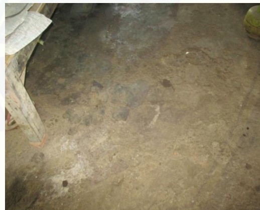
Kondisi Lantai Tidak Memenuhi Persyaratan dan Keadaan Kotor
