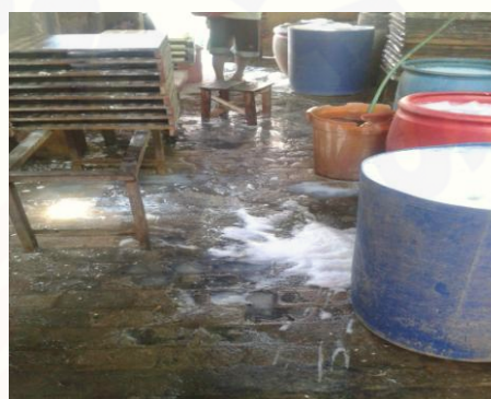
Gambar 4.4 Kondisi lantai industri tahu
