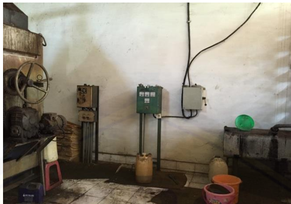
Gambar 4.13 Instalasi Listrik Agroindustri
