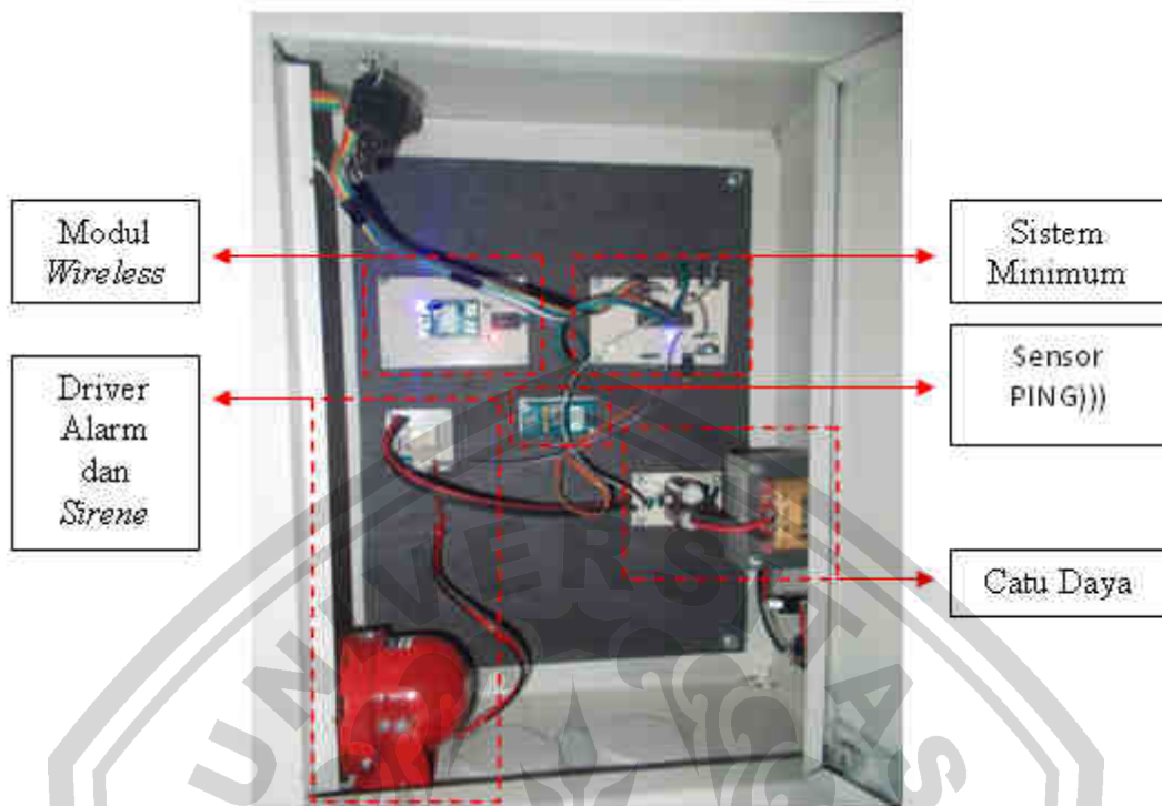
A. Bagian dalam Kotak Panel
