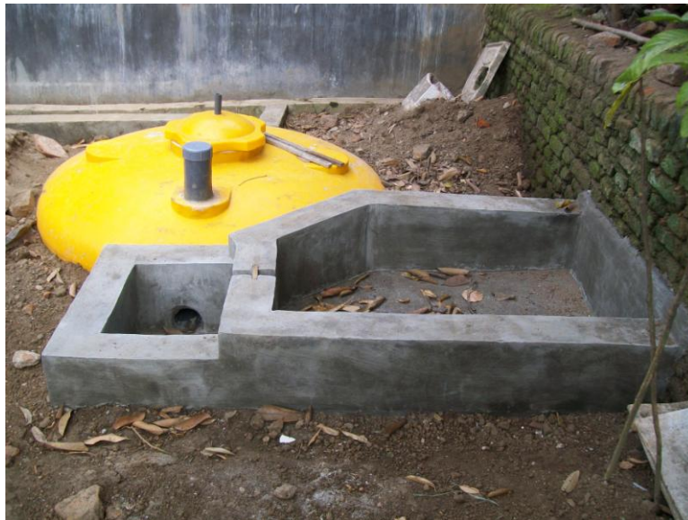
Gambar 14. Instalasi Reaktor Biogas
