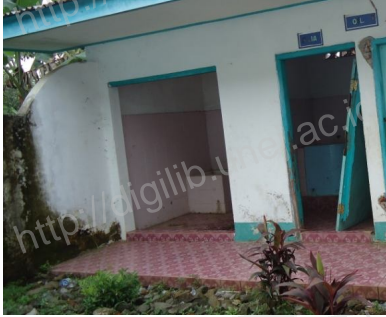
Gambar pintu kamar mandi rusak
