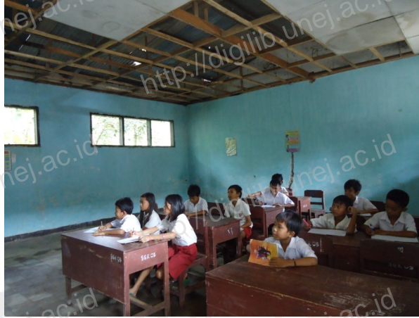
Gambar 4.3 Langit-langit dalam kondisi rusak
