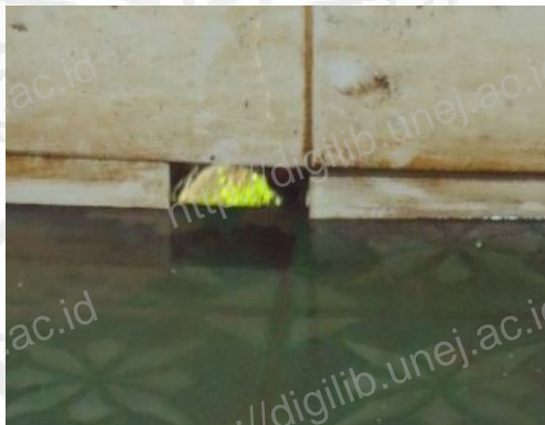
Gambar 4.29 Saluran pembuangan air limbah berupa lubang yang langsung mengarah ke tanah
