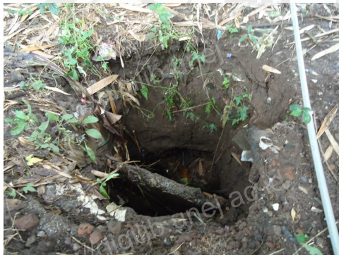
Gambar Septic Tank yang rusak
