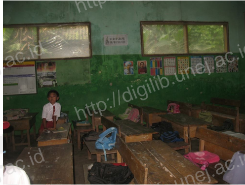
Gambar 4.6 Ventilasi SDN Jelbuk 02 ditutup dengan plastik bening
