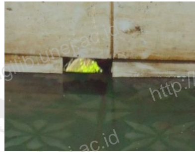
Gambar saluran pembuangan air limbah berupa lubang yang langsung mengarah ke tanah
