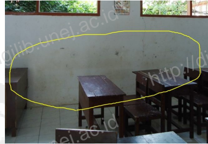
Gambar kondisi dinding kotor
