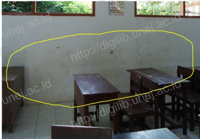
Gambar 4.2 Kondisi dinding kotor
