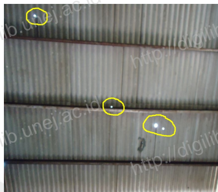
Gambar 4.5 Atap asbes berlubang
