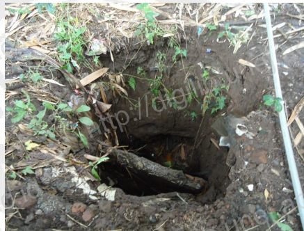
Gambar 4.31 Septic Tank yang rusak
