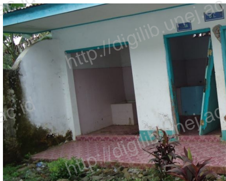
Gambar 4.30 Pintu kamar mandi yang rusak
