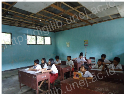
Gambar langit-langit dalam kondisi rusak
