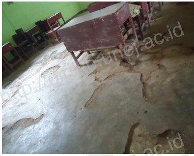
Gambar lantai plester rusak dan berlubang
