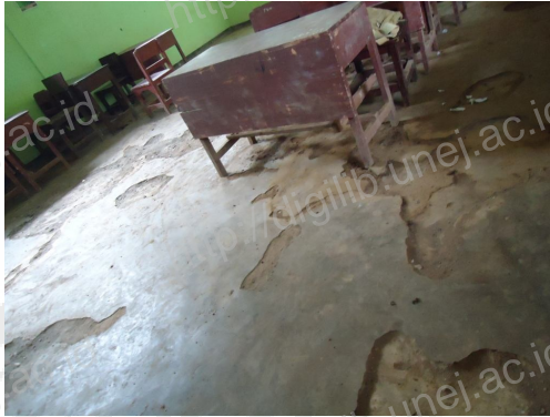
Gambar 4.8 Lantai plester rusak dan berlubang
