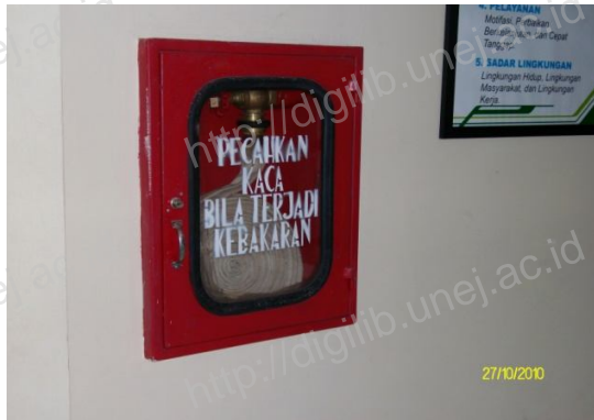
Gambar 4.7 Hidran yang berada di Gedung Administrasi
