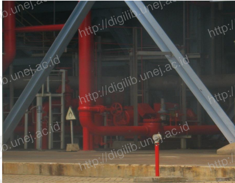
Gambar 4.6 Pipa Penyalur Air Pemadam
