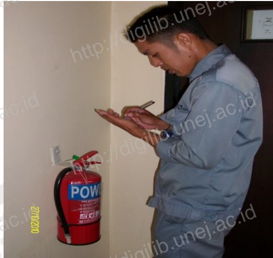
Gambar 4.10 Pengecekan APAR yang dilakukan oleh petugas
