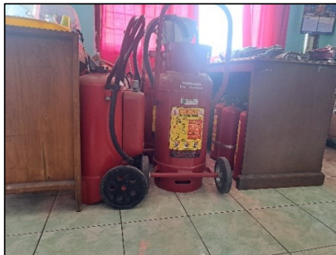
Gambar 4. 11 Alat Pemadam Kebakaran Sumber: Data Primer, 2023
