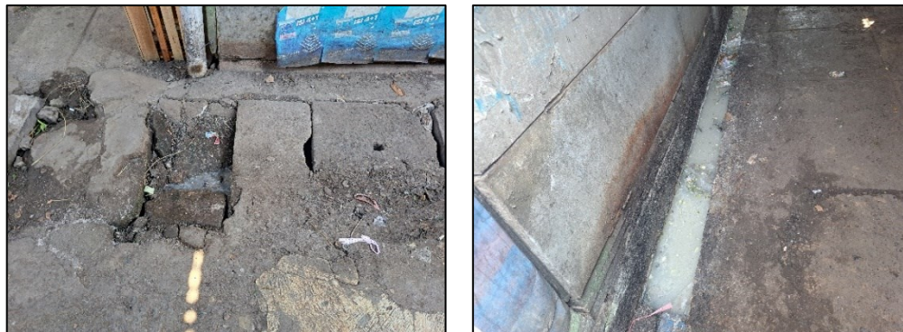
a. Kondisi saluran drainase di dalam bangunan pasar
