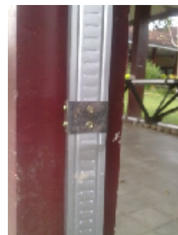
Foto A.5 & B.6 kerusakan yang terjadi pada benda uji
