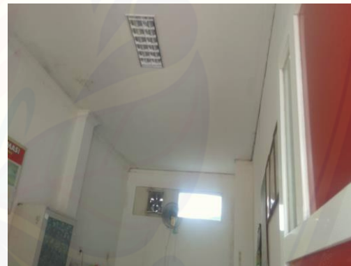
Gambar 16. Ventilasi dan Lampu PLC
