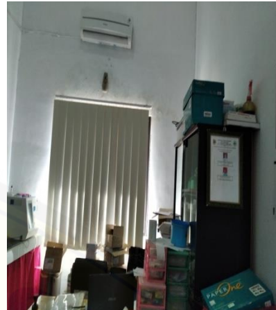
Gambar 14. AC Ruang Laboratorium
