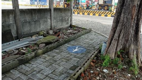
Gambar 1 Penanda jalur pedestrian pada perempatan jalur lapangan penyimpanan yang hanya memiliki logo pada permukaan dan tidak memiliki rambu penanda arah (gambar diambil pada 17 Maret 2020)
