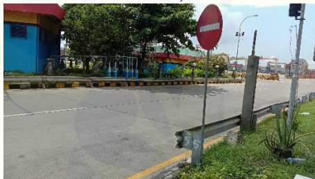
Gambar 3 Longitudinal steel barrier yang terpasang pada sisi jalur kendaraan sebagai pelindung pada area perempatan jalur lapangan penyimpanan (gambar diambil pada 17 Maret 2020)
