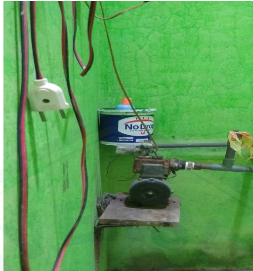
Gambar K.19 Pompa Air
