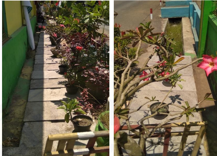
Gambar K.26 Saluran drainase
