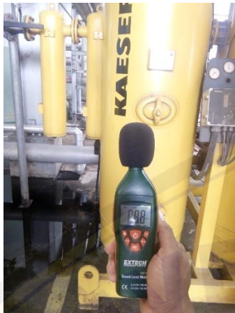
Pengukuran kebisingan pada area mesin kompresor
