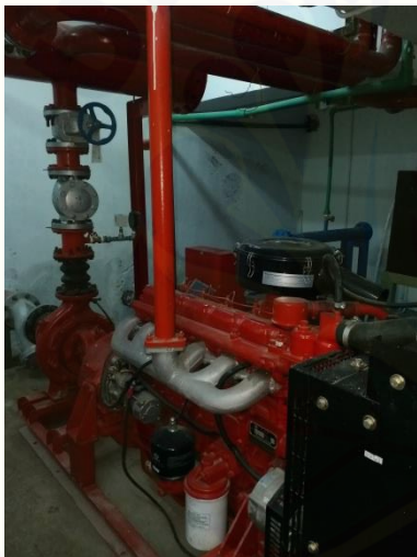
Gambar 11. Sistem Pompa Air (3)
