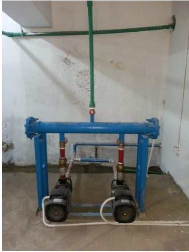
Gambar 9. Sistem Pompa Air (1)
