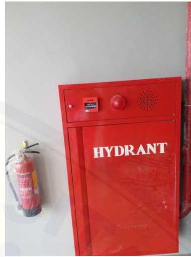
Gambar 2. Sistem Hydrant dan APAR
