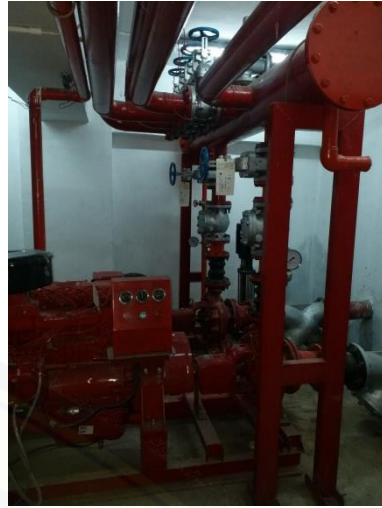
Gambar 10. Sistem Pompa Air (2)
