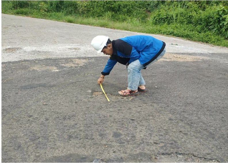
Gambar 3. Proses pengamatan kerusakan
