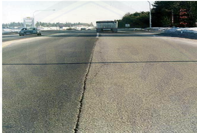
Gambar 2.4 Retak sambungan jalan
