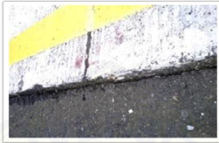
Gambar 2.5 Retak sambungan pelebaran samping
