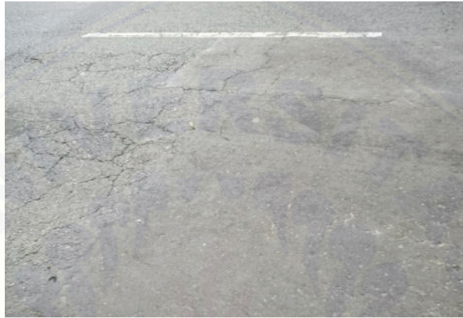
Gambar 2.1 Kerusakan jalan keriting Sumber: Hardyatmo, 2007
