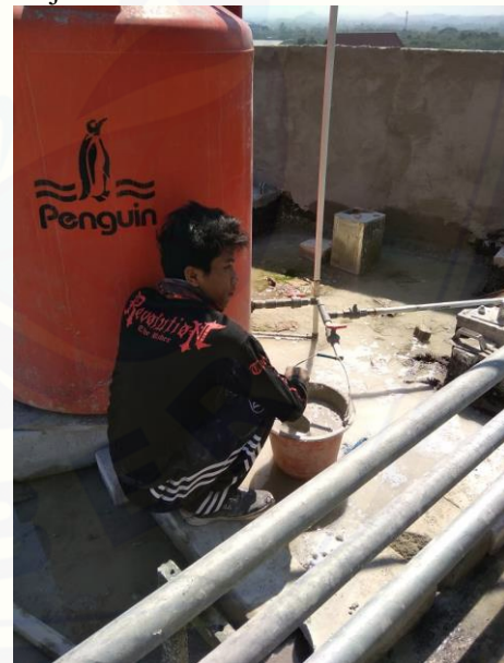
Gambar 4. Pekerja tidak menggunakan APD lengkap
