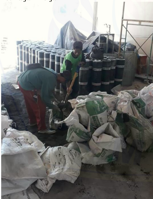
Gambar 11. Pekerja tidak memakai APD
