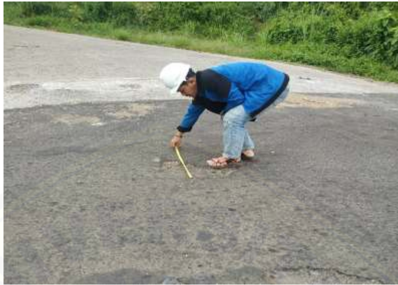
Gambar 3. Proses pengamatan kerusakan
