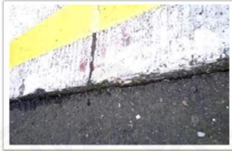
Gambar 2.5 Retak sambungan pelebaran samping
