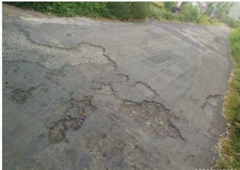
Gambar 4. Kondisi eksisting ruas Gondoruso-Dampar
