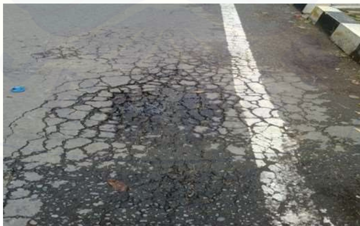
Gambar 2.2 Retak kulit buaya Sumber : Hardyatmo, 2007
