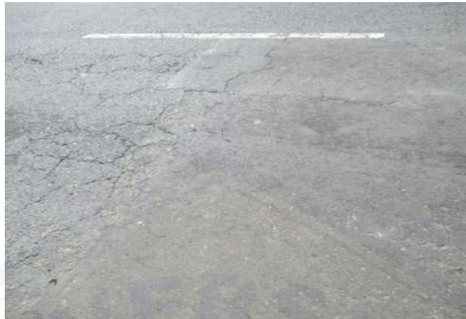
Gambar 2.1 Kerusakan jalan keriting Sumber: Hardyatmo, 2007
