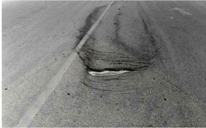
Gambar 2.6 Retak Selip Sumber : Google
