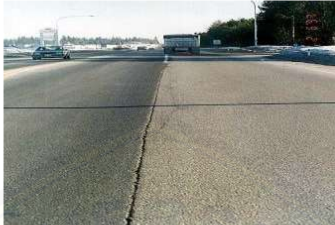
Gambar 2.4 Retak sambungan jalan
